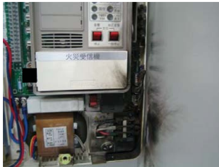
火災報知器の被害
