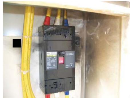
ブレーカーの被害
